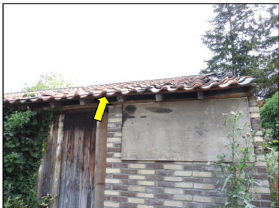
Figuur 17. Ruimte tussen de betimmering en dakpannen waar huismus en vleermuizen gebruik van kunnen maken.
